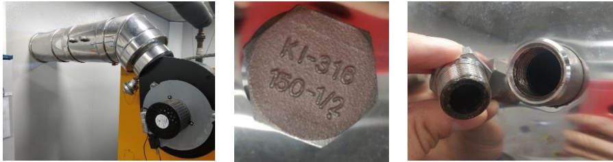
Ilustración 2. Chimenea caldera de biomasa.
